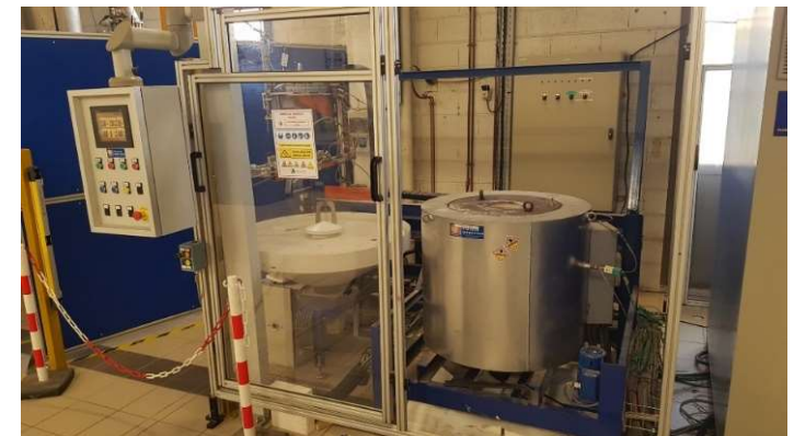
Vue de l'ensemble de l'installation
